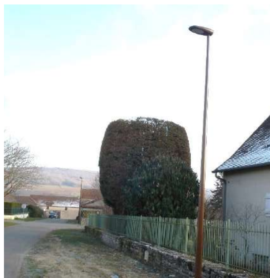
Nouveau lampadaire au croisement de la rue de l'Hôpital et de la rue de la Croix Matelin
